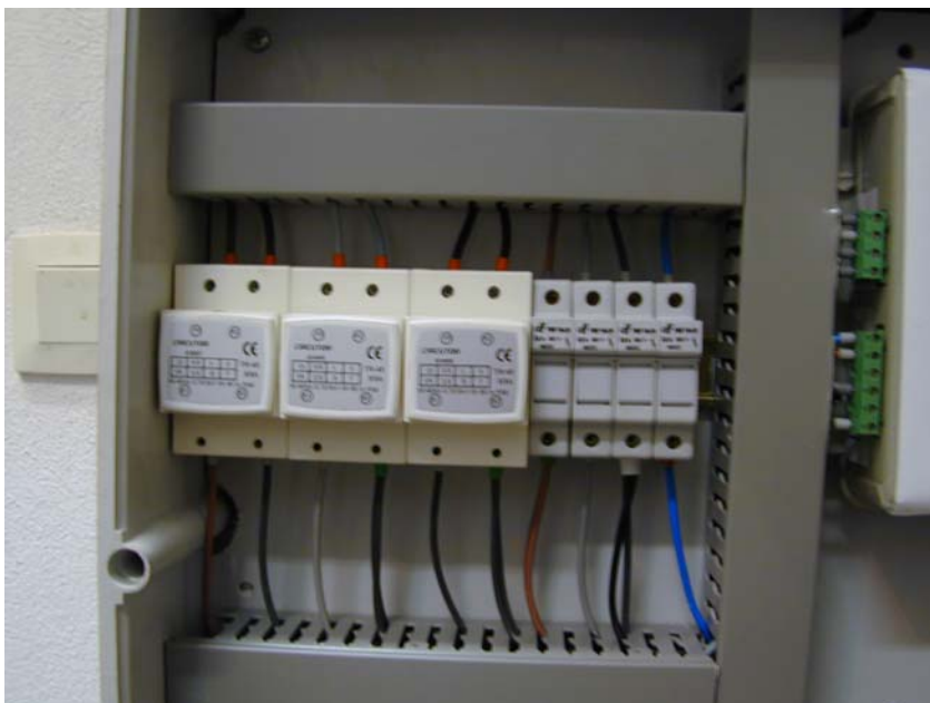
Figura 9. Detalle de los transformadores de corriente de aislamiento
